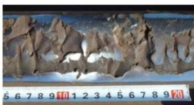
foto nr.7 - extinderea pe orizontală a lungimii zonelor concave fisurate linia II Km 256+200 șina din partea dreaptă
